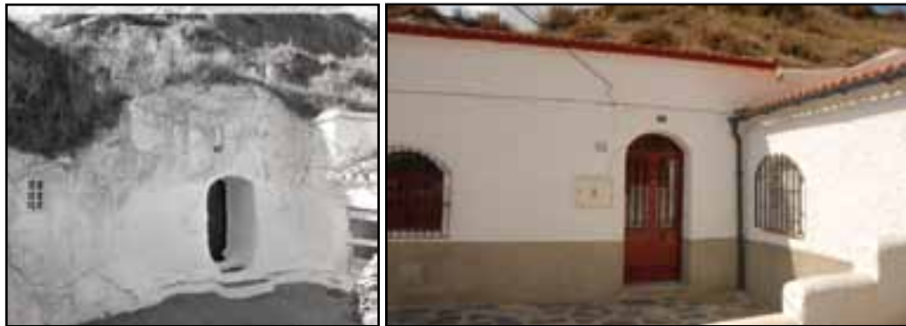
La misma cueva en 1971 y en 2011 tras ejecutarse obras de rehabilitación. Fotos Tati
